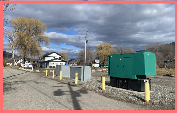
Seymour Liftstation and Generator
